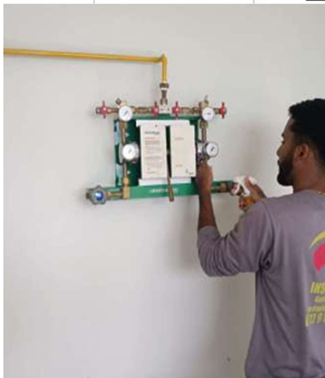
Manutenção preventiva em sistema de gases medicinais
