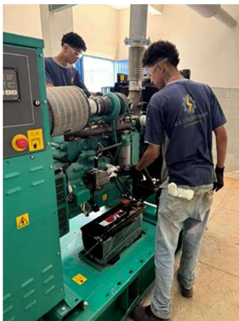
Manutenção preventiva de grupos geradores
