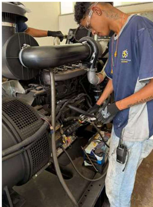
Manutenção preventiva de grupos geradores
